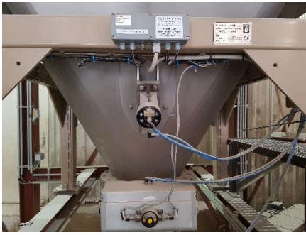
Kabelgebundene Sensoren am Premixer
