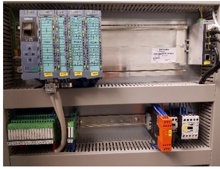
Zugangsgeschützter Bereich der Sensorverkabelung
